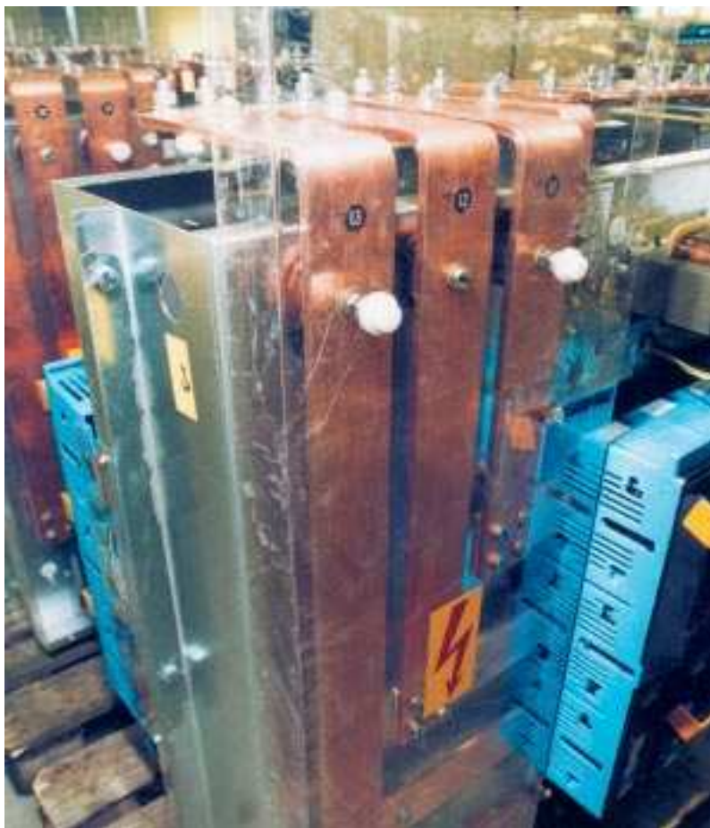
Herzstück der Windmühlen-Elektrik: Mittelspannungs-Anlage für die Trafostation einer Turbine
